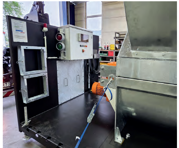
Schaltschrank mit SPS-Steuerung und Ampel
