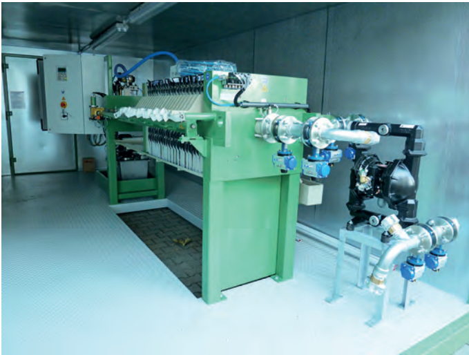
Kammerfilterpresse – montiert in Container (mobil)
