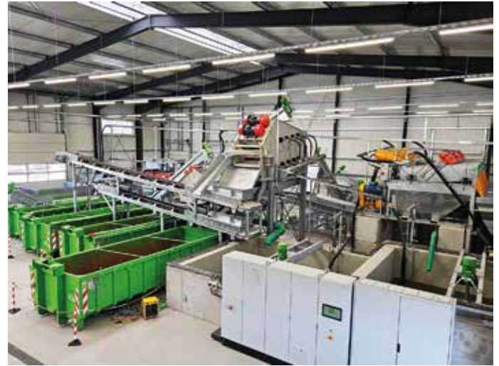
Recyclinganlage mit Containern für Mineralikfraktionen
