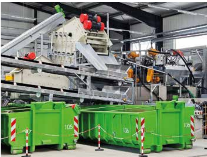
Nassklassieranlage mit Containern
