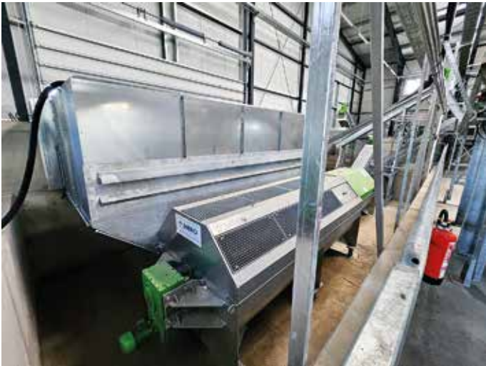
Recyclinganlage Bereich 1 mit Dosierpuffer
